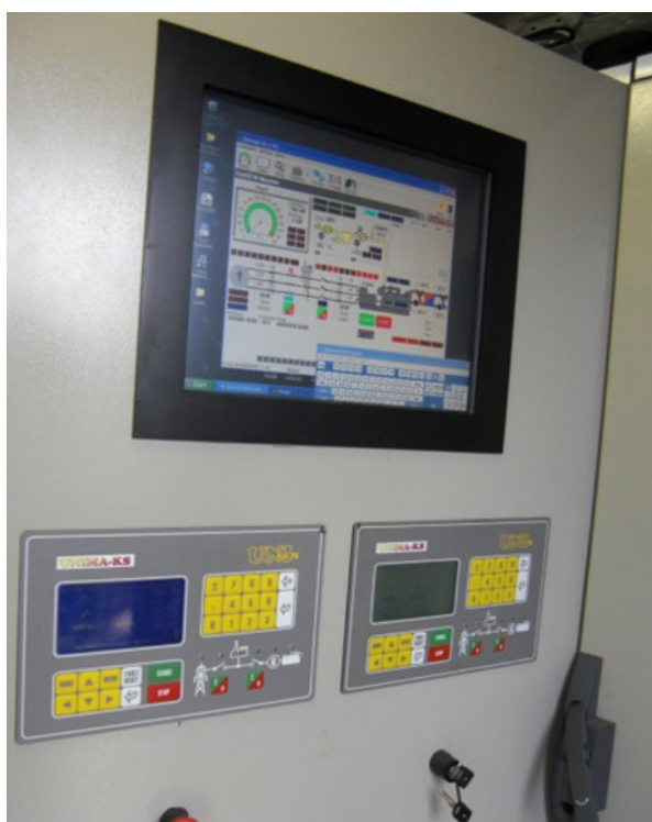
Control panel in Gyál.
